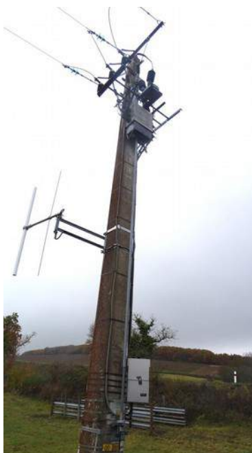
Transformateur de Sagy
