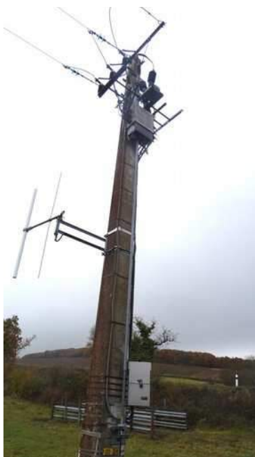
Transformateur de Sagy
